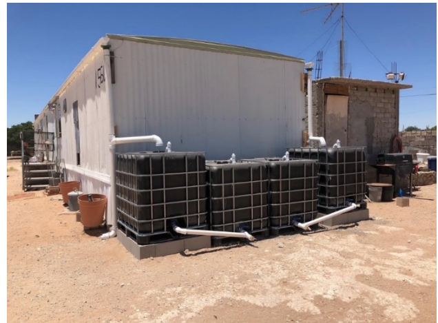
Sistema de recolección de agua de lluvia en una casa móvil en la Colonia Cochran, condado de El Paso, Texas.
